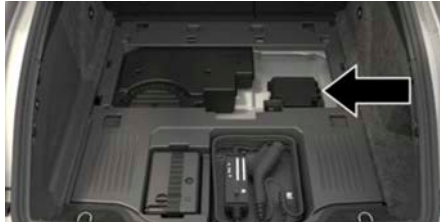
Centro de distribución de energía trasero
