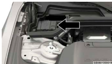
Centro de distribución de potencia delantero
