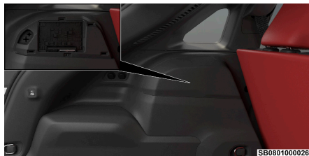
Centro de distribución de energía trasero
