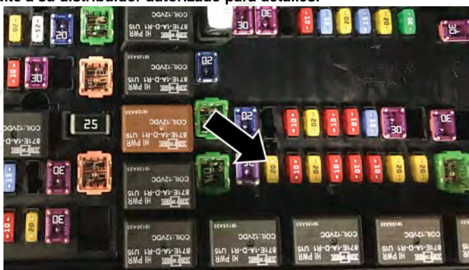
Fusible de la toma de corriente en el panel trasero
