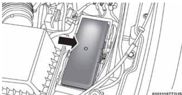
Centro de distribución de poder
