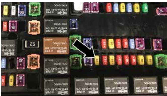
Panel de fusibles de la toma de energía derecha trasera
