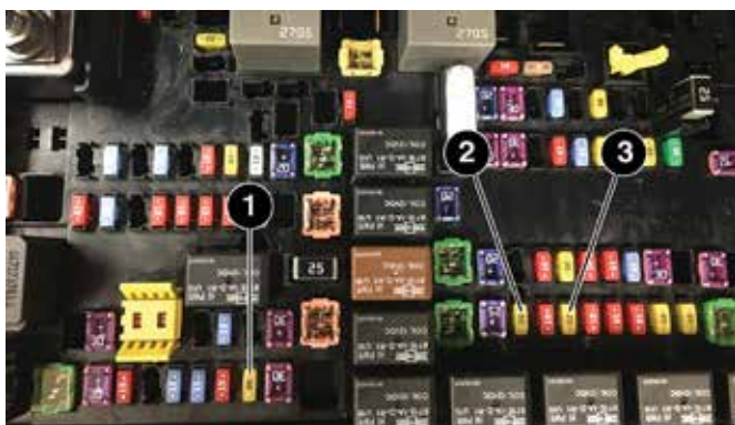
Localización de los fusibles de las tomas
