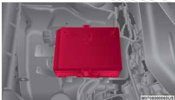
Centro de distribución frontal de energía
